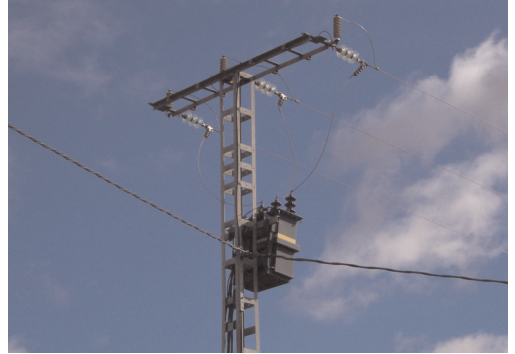
Tendido eléctrico: una de las amenazas de las aves esteparias.
